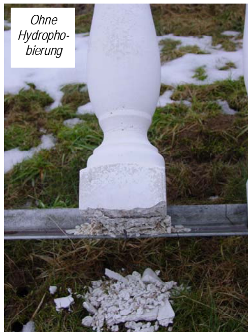
ungleichmäßiger, fleckiger Farbeindruck, Schwindrisse im Bereich der Einschnürung deutlich verschlimmert, Säulenfuß komplett zerstört, Alter ca. 12 Monate
